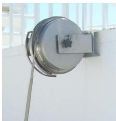
شکل ۱۸- کابل اتصال جمع‌شونده RGA روی مخازن سقف شناور
